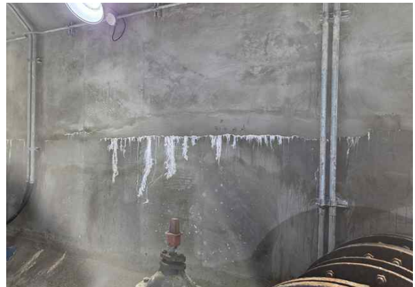
<유출밸브실 내부 벽체 균열부백태>
