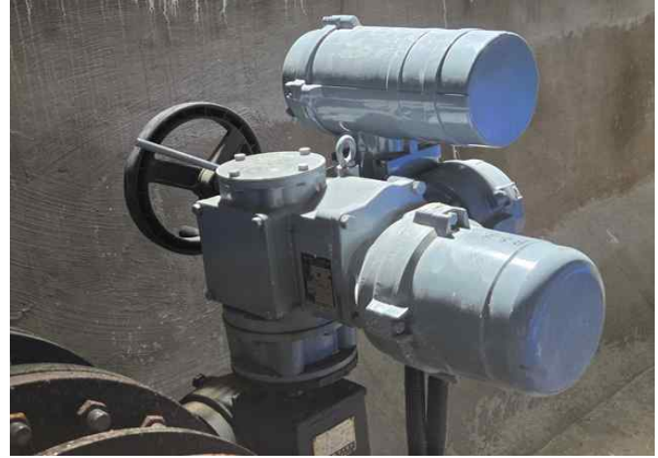
<유출 액츄에이터 상태양호>
