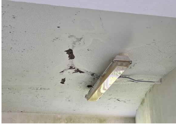
<검수실 내부 상부슬래브 도장박리>
