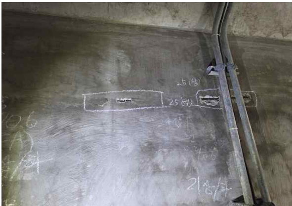
<유입밸브실 내부 벽체 철근노출>
