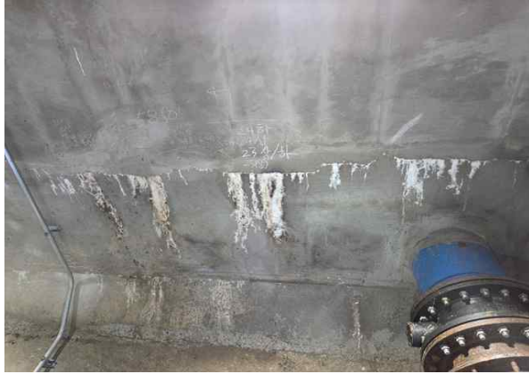
<유출밸브실 내부 벽체 균열부백태>
