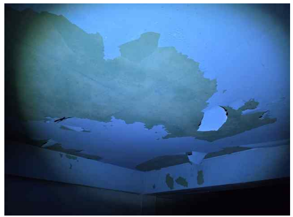
<1지 상부슬래브 도장박리, 박락>
