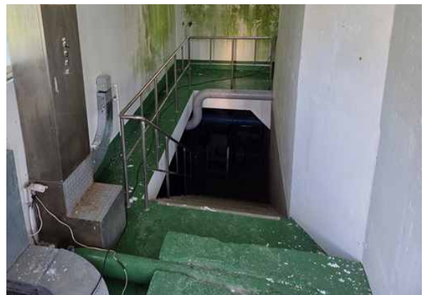
<배관검수실 바닥 상태양호>
