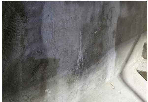
<유입밸브실 내부 벽체 균열부백태>
