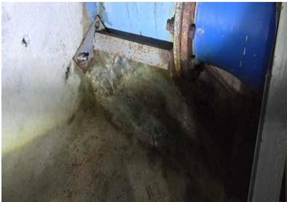
<유입밸브실 내부 벽체 백태>
