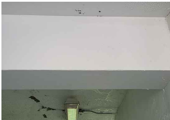
<검수실 내부 보 균열>
