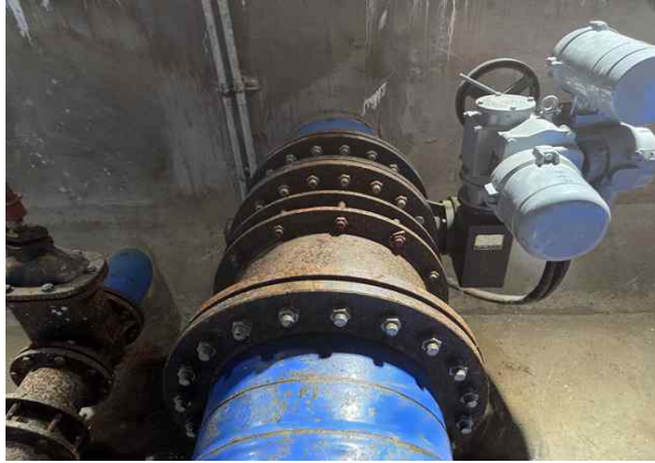
<유출 밸브, 배관, 볼트류 부식>
