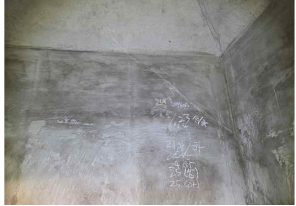
<유입밸브실 내부 벽체 균열>
